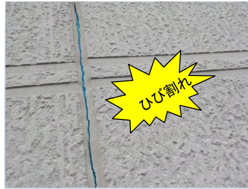
コーキングのひび割れ
