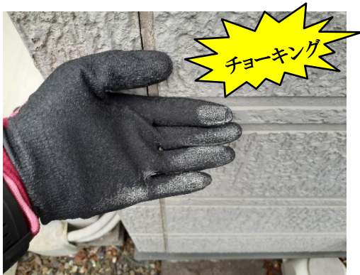
手に外壁塗料が付く状態 (チョーキング)
