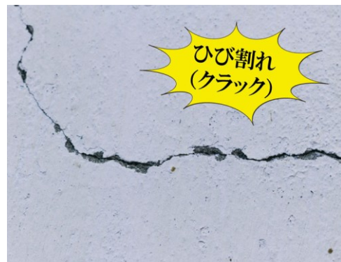
外壁にひび割れが生じた状態 (クラック)
